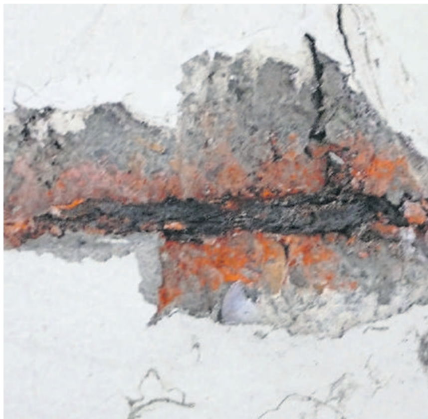
Betonabplatzungen lassen Armierungseisen zum Vorschein kommen.
